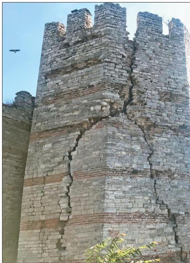
Рис.7. Башни древней стены Феодосия в Стамбуле с антисейсмическими поясами и со следами обрушения и растрескивания за счет сильного ( \geq VIII баллов) землетрясения. Снимок 2018 г.
